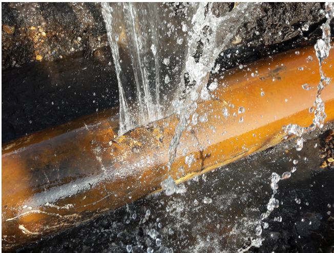
Vor der Reparatur
